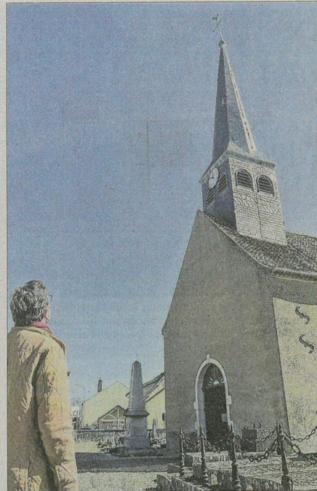
La flèche et le clocher ont été endommagés lors de la tempête de février 2020. Photo JSL/Florent MULLER
